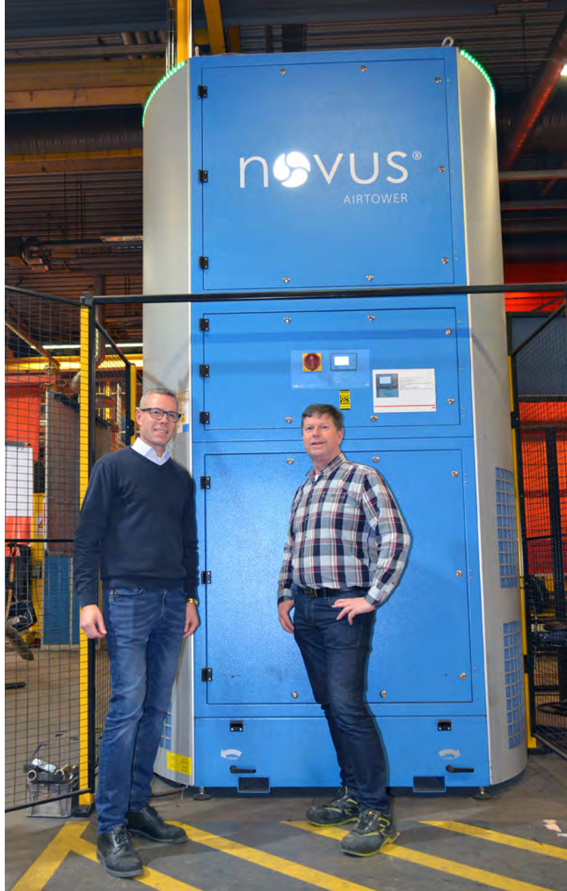
Johan Andersson och Kent Karlsson framför en av de nyare miljöinvesteringarna. Ett av tre luftreningsstorn.
